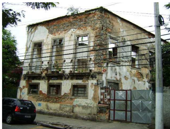
Foto14: Rua Gal. Osório - edificação em ruína Fonte: SUEP-UFF (2009)
